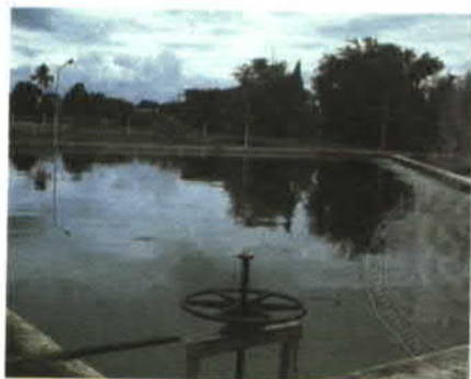
ปลักเก็บน้ำที่สถานีสูบน้ำบ้านคลองยาว
