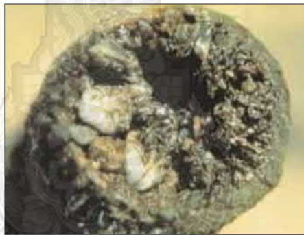
กลุ่มหอยซีบรามัสเซล ที่เกาะติดและอุดตัน ด้านในของท่อส่งน้ำ
