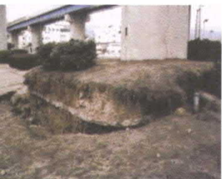
พื้นดินไถ่ตอม่อสะพานทรุด หลังเกิดแผ่นดินไหว
