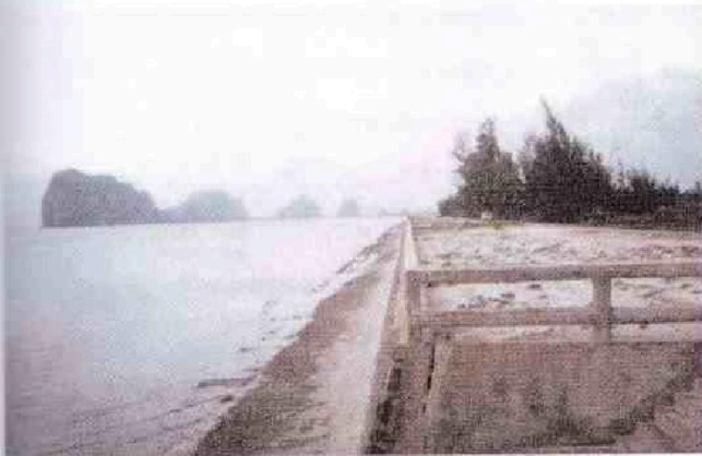
แนวกันคลื่นชายฝั่ง บริเวณหาดปากเมง อำเภอสิเกา จังหวัดตรัง ในลักษณะกำแพงคอนกรีตเสริมเหล็ก มีหินทิ้งด้านหน้า (ที่มา : หนังสือ "การเปลี่ยนแปลงพื้นที่ชายฝั่งด้านทะเลอันดามัน" ของกรมทรัพยากรธรณี)
